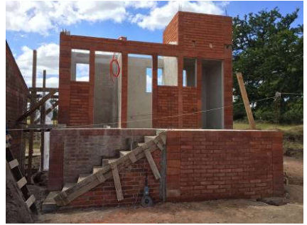
Zisterne und Trockentoiletten
