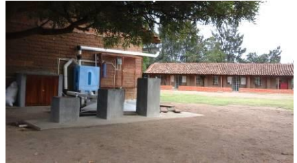
Regenwassertank und Aufbereitungsanlage
