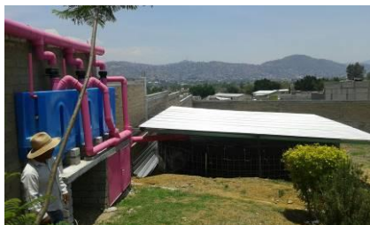
Zisterne und Wasseraufbereitung für die Brustkrebeklinik des Grupo de Recuperación Total (RETO) in Oaxaca
